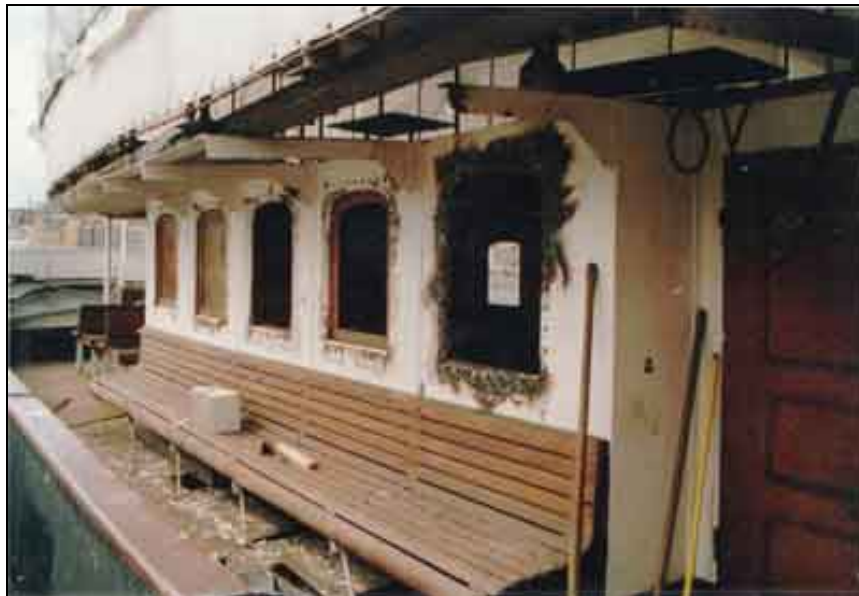
Abb. 6: Eine verfallene Außenwand der Alexandra 1985
